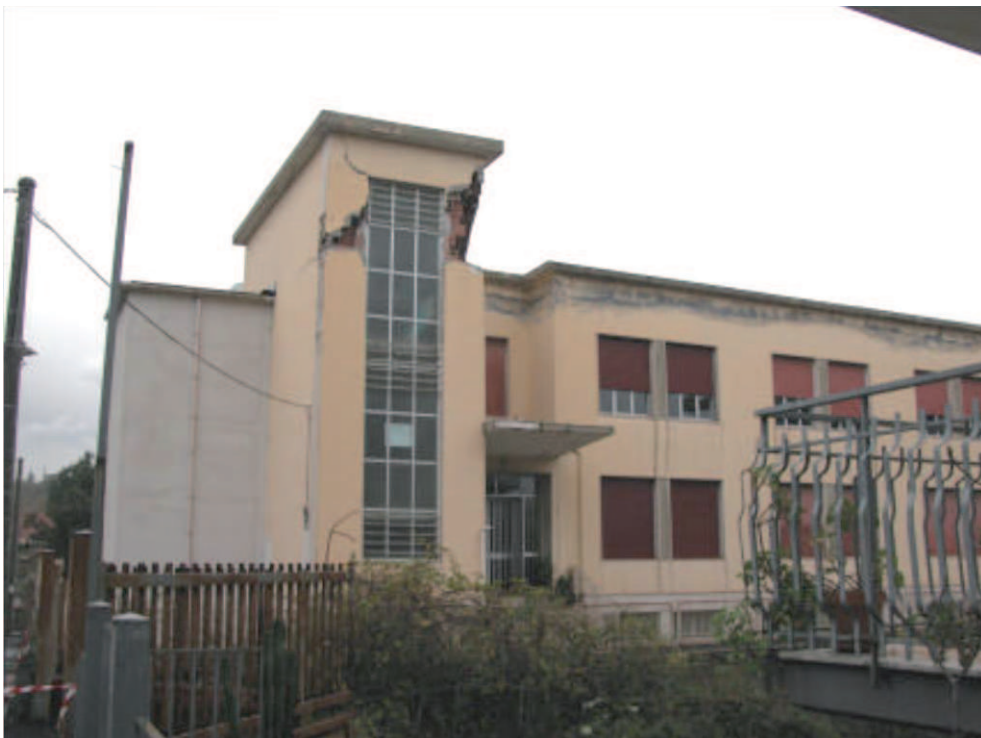
Figura 1.15 - Macchia di Giarre: Scuola elementare danneggiata dal sisma. Foto DRPC del dicembre 2002.
