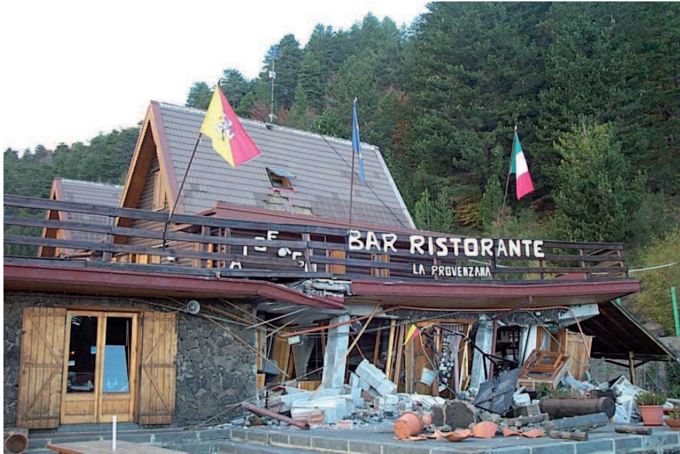
Figura 1.9 - Linguaglossa - Piano Provenzana: crollo parziale delle strutture del ristorante La Provenzana a seguito degli eventi sismici - Foto DRPC del 27/10/2002 (P. Marano).
