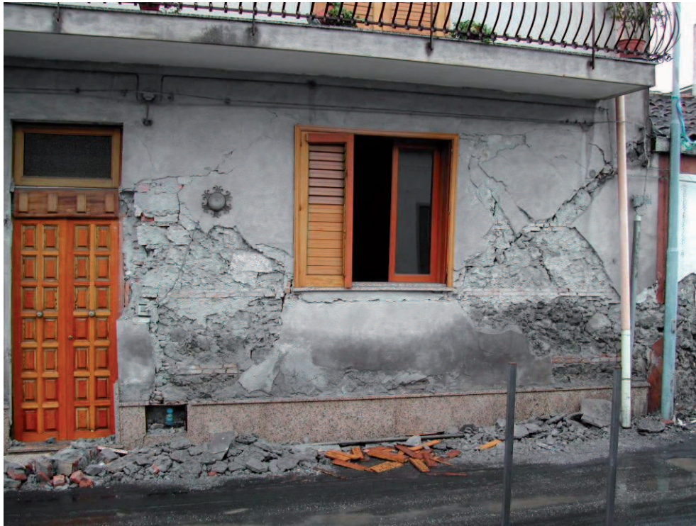
Figura 1.12 - Zona a confine tra Santa Venerina e Acireale – Lesioni di taglio con andamento ad X nella parete basamentale - Foto DRPC del novembre 2002.
