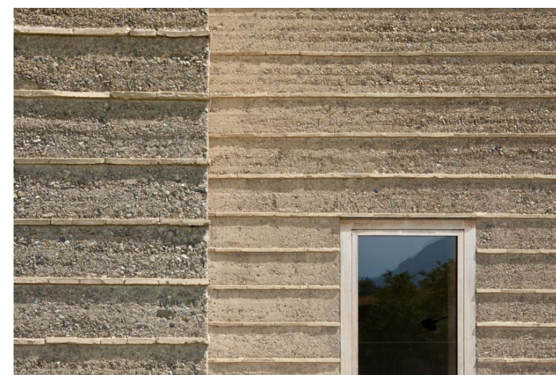
A destra. Erosione controllata sulla facciata della casa Rauch a Schlins, Austria.
