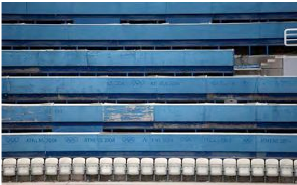
2012, Decadimento di impianti olimpici
