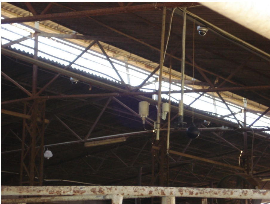
Figura 10 – Sensori per la misurazione dei dati termo-igrometrici all'interno dell'edificio zootecnico
