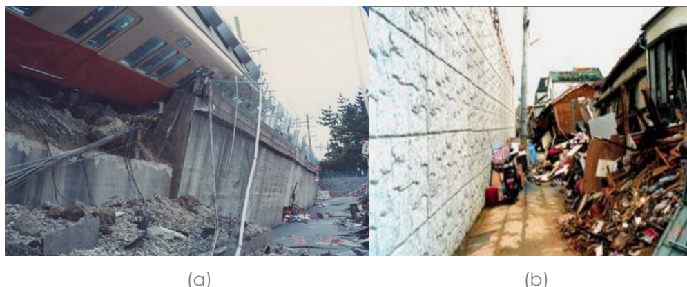
FIG. 1. 40 – (a) Muro di sostegno in cemento armato dopo il terremoto di Kobe; (b) muro in terra rinforzata dopo il terremoto di Kobe.
