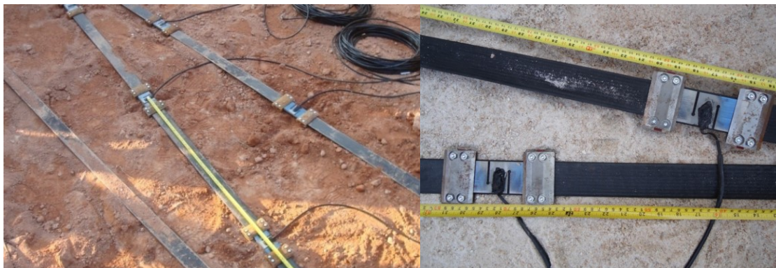
FIG. 2. 33 – Posizionamento dei lettori di deformazione
