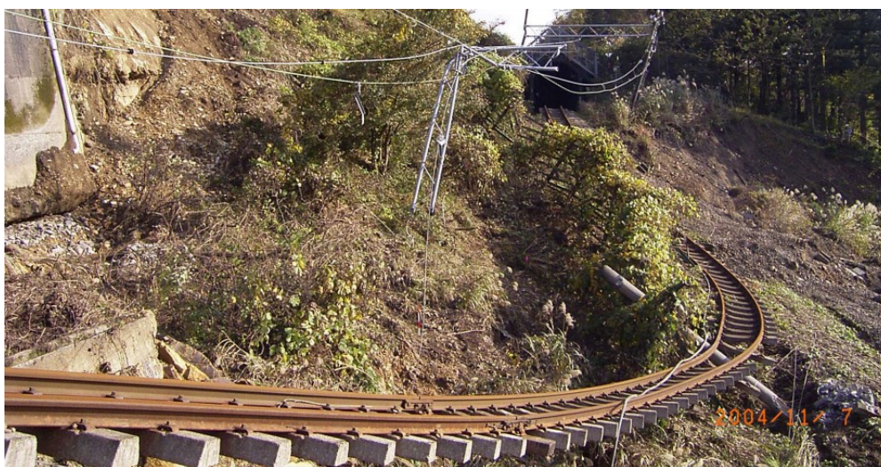
FIG. 1. 55 - Collasso del rilevato ferroviario dopo il terremoto di Niigata.
