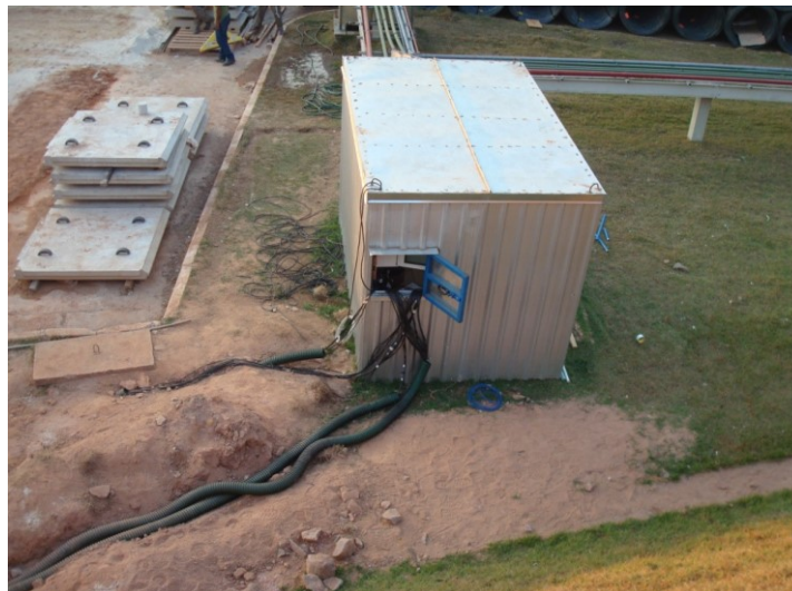
FIG. 2. 36 – Sistema di acquisizione dati
