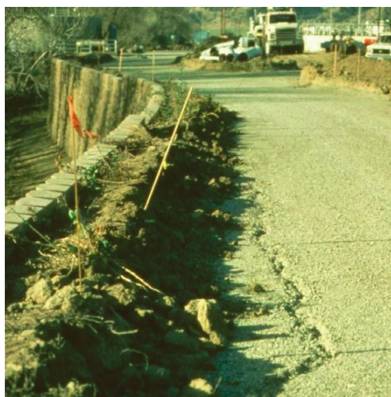
FIG. 1. 42 – Danni riportati sul "Valencia Wall" a seguito del terremoto di Northridge 1994.
