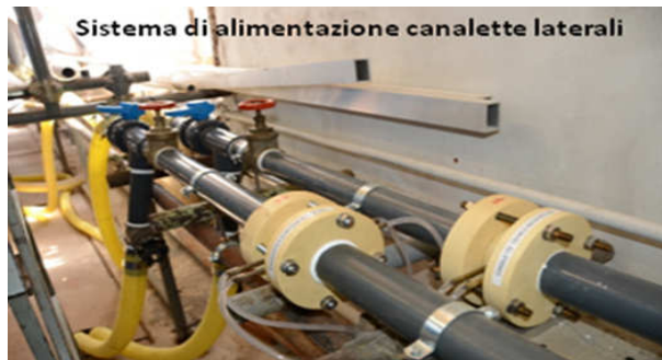
Figura 5.5 Sistema di alimentazione idrica che consente la regolazione della portata in ingresso alle due canalette laterali
