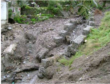
Figura 4.12 Torrente Sopra Urno: opere di protezione realizzate dal Genio Civile di Messina a seguito dell'evento del 2007.
