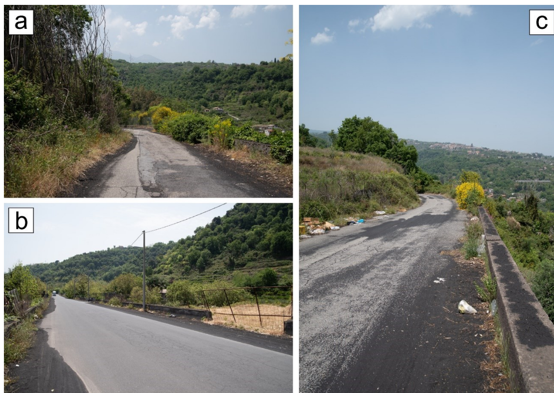
Fig. 8.32 – Situazioni di rischio geomorfologico: a) Aspetto delle Timpe di Miscarello; b) Via Damasco; c) Via della Regione alla base delle Timpe. (Ubicazione foto in Fig. 8.33).
