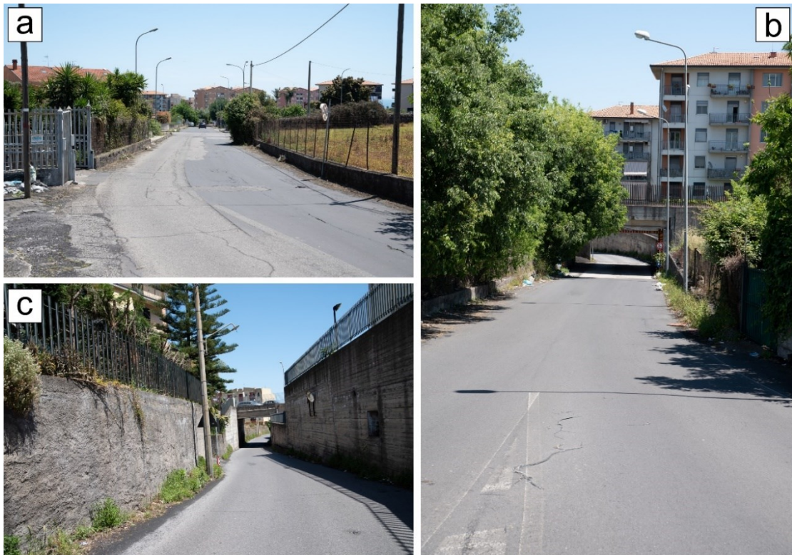
Fig. 8.8 – La via Luigi Settembrini nella zona di Altarello: a) Inizio della via Settembrini con pendenza verso est (manto stradale molto rovinato); b) Zona di canalizzazione delle acque in prossimità del primo viadotto; c) Secondo viadotto (ubicazione foto in Fig. 8.9).
