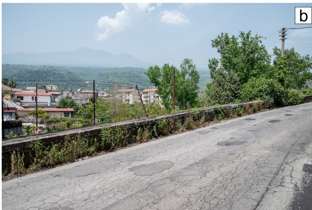
Fig. 8.29 – Aree di Macchia di Giarre interessate dal passaggio della faglia San Giovanni Montebello – Codavolpe: a) Incrocio tra Viale Mediterraneo e via Carlo Parisi; b) parte iniziale di via delle Acacie, caratterizzata da asfalto in pessime condizioni; sullo sfondo, verso ovest, si intravedono le Timpe di Miscarello. (Ubicazione foto in Fig. 8.30).
