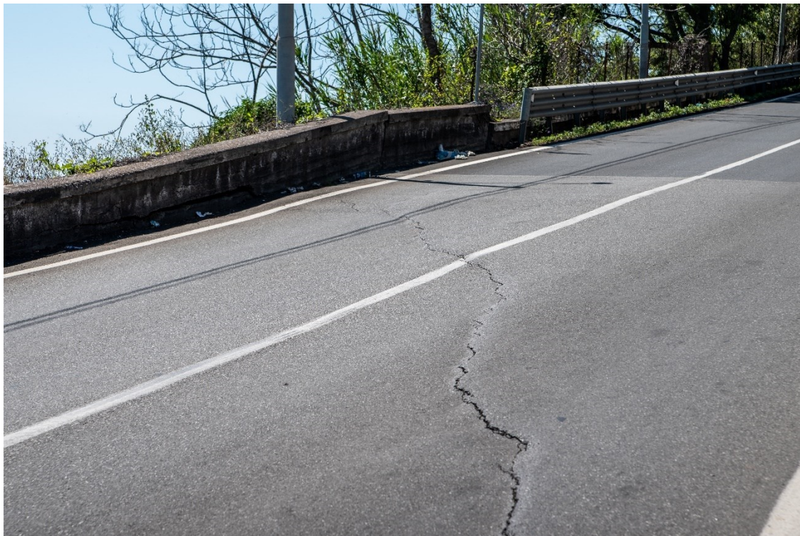
Fig. 8.23 – Fratturazione dell'asfalto lungo la via Madonna della Libertà nella frazione di San Leonardello (ubicazione foto in Fig. 8.27).
