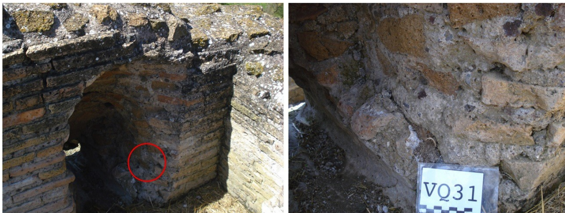
Figura 18. A sinistra foto generale del paramento murario dal quale è stato prelevato il campione VQ31 (foto a destra).
