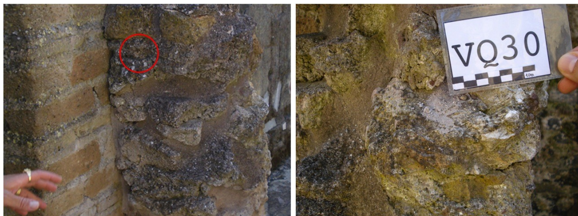
Figura 17. A sinistra foto generale del paramento murario dal quale è stato prelevato il campione VQ30 (foto a destra).
