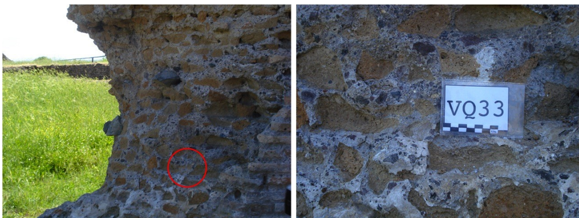
Figura 19. A sinistra foto generale del paramento murario dal quale è stato prelevato il campione VQ33 (foto a destra).
