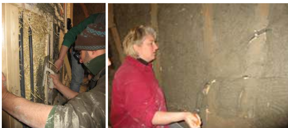
Figg. Il cantiere scuola della Casa di ToTi: posa in opera dell'intonaco su pareti in balle di paglia e terra paglia. Foto dell'autore
