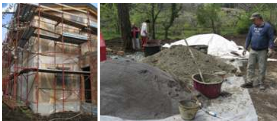
Figg. Il cantiere scuola della Casa di ToTi: preparazione dei componenti degli intonaci, la sabbia lavica e l'argilla del Simeto. Foto di Elisabetta Campisi
