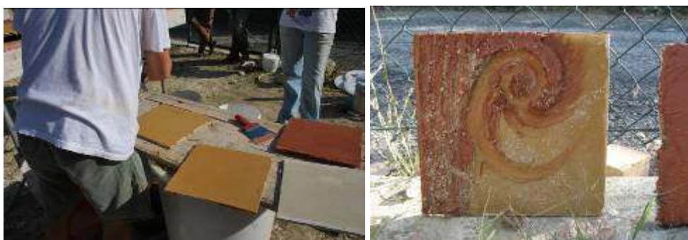
Figg. Il cantiere della "casa di Teresa" del Comune di Casalinocontrada: dimostrazione con applicazione degli intonaci di finitura a base di terra della ditta Brioni, preparazione dei provini e interpretazioni libere. Foto dell'autore
