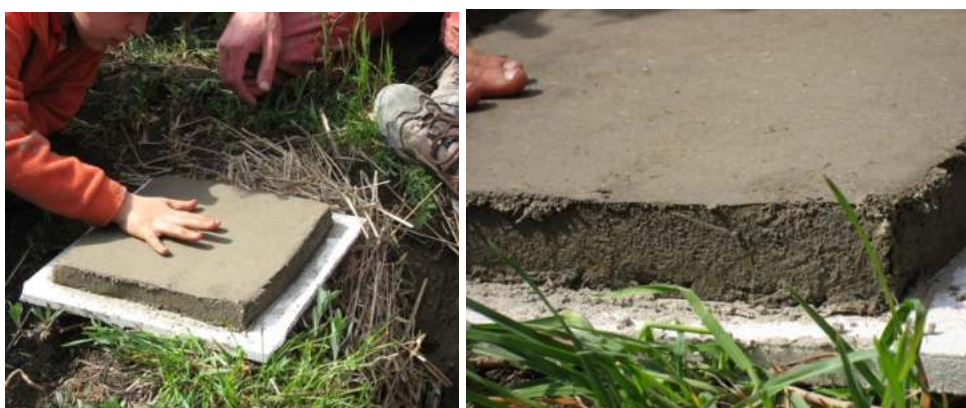
Figg. Il cantiere scuola della Casa di ToTi: prototipo di pavimento in terra cruda. Foto dell'autore
