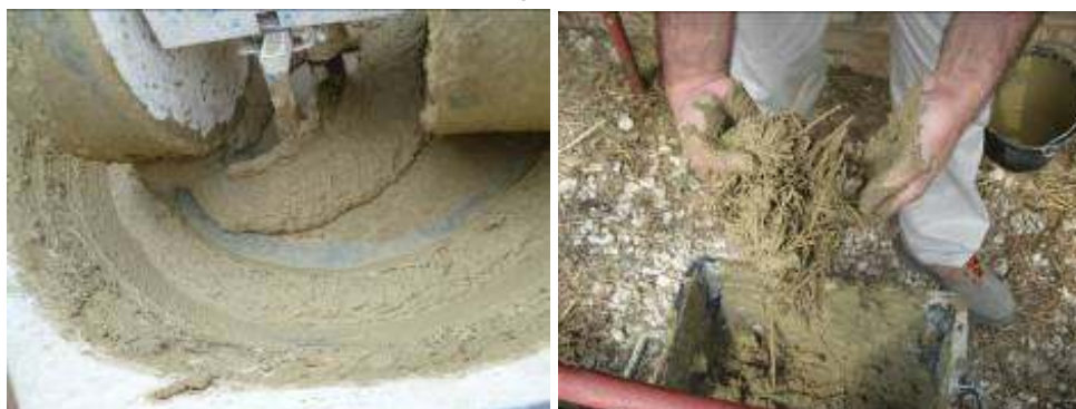
Figg. Il cantiere della "casa di Teresa" del Comune di Casalincontrada: preparazione dell'impasto con la terra cruda e impasto pronto per le sarciture delle lesioni. Foto dell'autore e di Elena Bignamini
