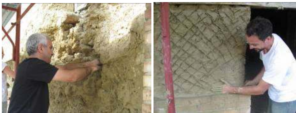
Figg. Il cantiere della "casa di Teresa" del Comune di Casalincontrada: posa in opera dell'impasto con la terra cruda e parete ripristinata pronta per l'intonaco. Foto di Elisabetta Campisi e di Elena Bignamini
