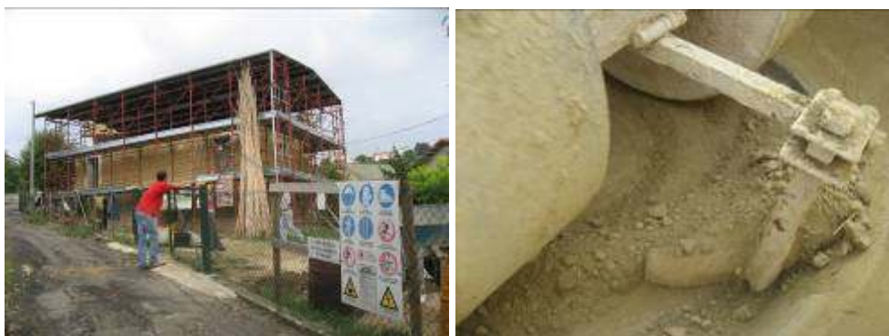
Figg. Il cantiere della "casa di Teresa" del Comune di Casalcontrada: immagine del cantiere e f rantomazione della terra. Foto dell'autore
