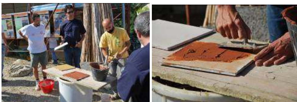
Figg. Il cantiere della "casa di Teresa" del Comune di Casalinocontrada: dimostrazione con applicazione degli intonaci di finitura a base di terra della ditta Brioni, arch. Matteo Brioni. Foto dell'autore
