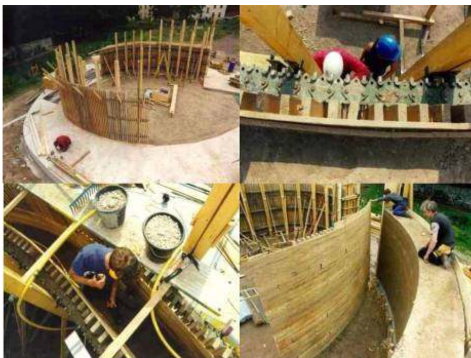
Fig. 48, costruzione in terra battuta, cantiere della Chiesa della Riconciliazione Reitermann & Sassenroth con Martin Rauch, Berlino, Germania 1999-2000
