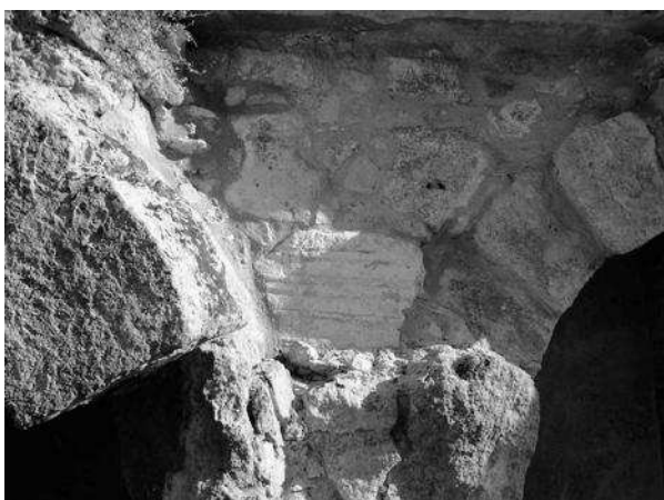
Fig. 11. San Foca, esterno, navata sinistra. Particolare del primo pilastro occidentale con reimpiego di cornice o cippo romano.
