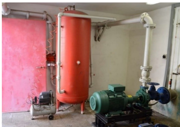
Figura 5.2 Fotografia del locale pompe del laboratorio
