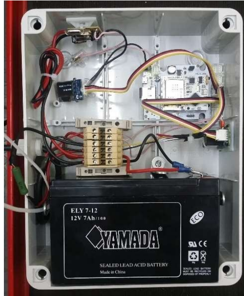
Figura 7.2 Dispositivo realizzato per le misure di pressione di campo
