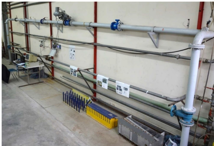
Figura 5.1 Condotta strumentata nel laboratorio
