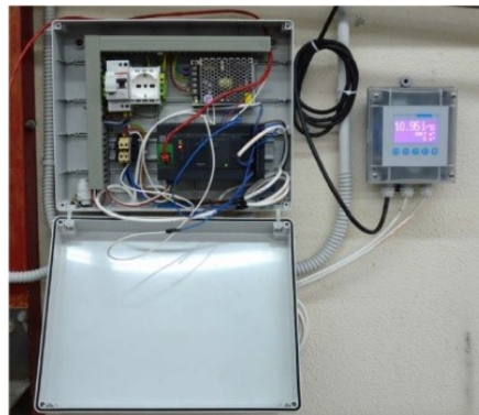
Figura 5.8 Quadro elettrico con PLC Schneider
