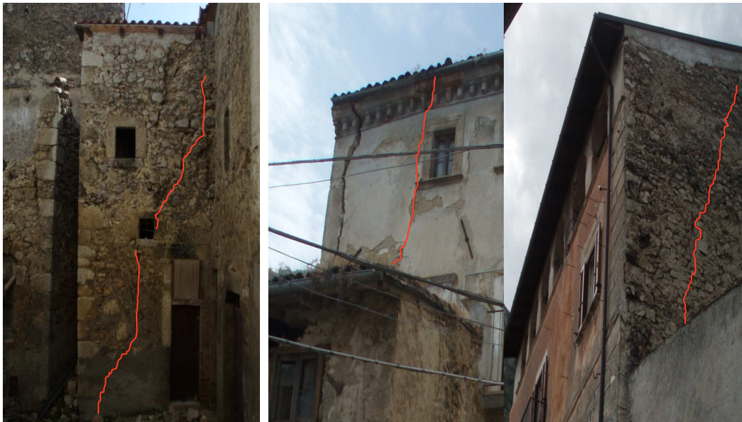
a) Prima fase: fessurazione e distacco di un'ampia porzione di muratura con \beta > 30^\circ
