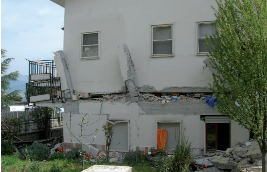
Foto 2 Pianola. Distruzione completa del primo piano.
