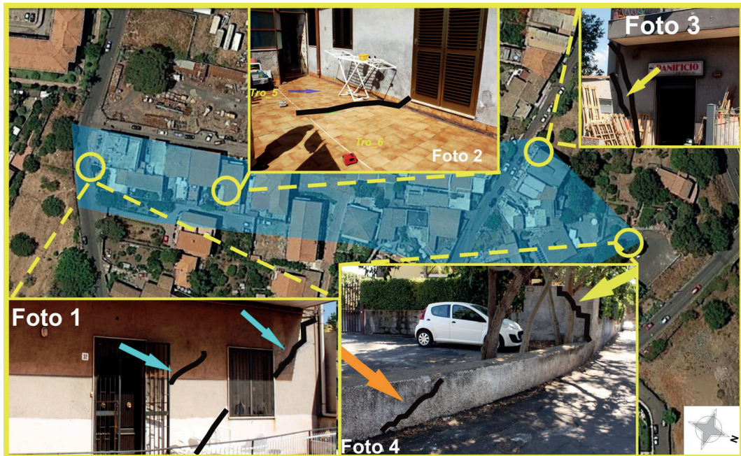
Fig. 2 – Particolare dell’area in cui sono state rilevate lesioni, sia al suolo che agli edifici.
