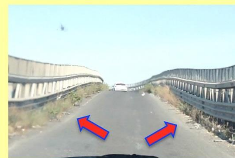
Segnaletica orizzontale scadente e non percepibile dagli utenti
