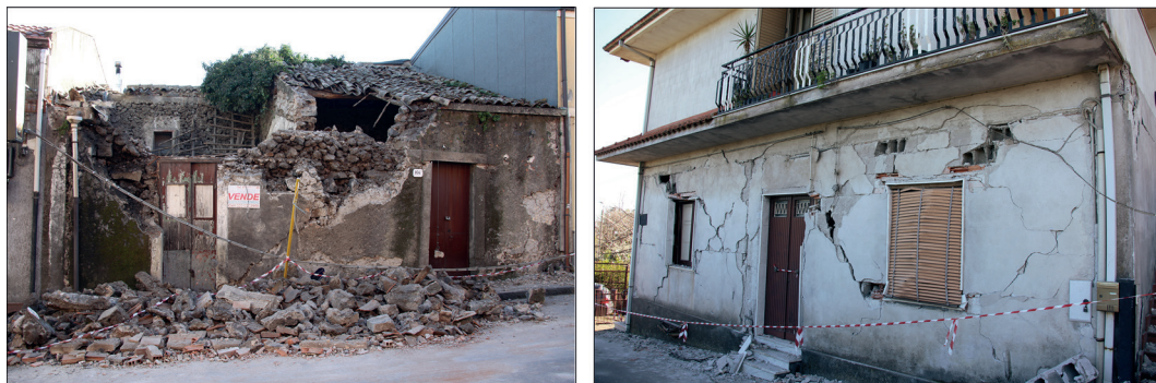
Fig. 1 - Fleri (sx): crollo di un edificio in pietra grezza (cl. A); Mazzasette (dx): danno grave (lesioni a croce di S. Andrea, grado 3) ad un edificio in muratura (cl. B).
