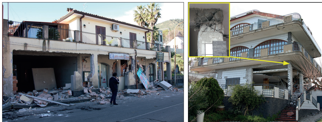
Fig. 2 - Fleri (sx): rottura dei tramezzi in un edificio in c.a. (cl. C); Mazzasette (dx): rottura dei pilastri e crollo delle tramezzature (grado di danno 4) in un edificio in c.a. (cl. C).
