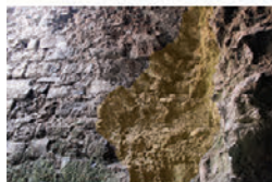
4. EROSIONE DEL MATERIALE LAPIDEO
