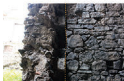
1. SCOLLAMENTO MURATURE ADIACENTI
