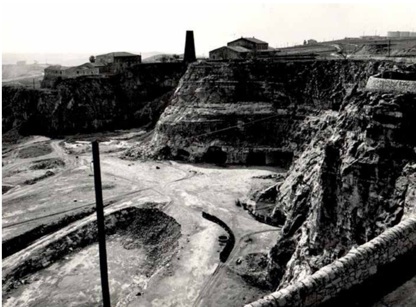
Fig. 24- Fronti scavo in cava e galleria negli anni cinquanta. Sullo sfondo la palazzina Limmer (Archivio documenti COLACEM)
