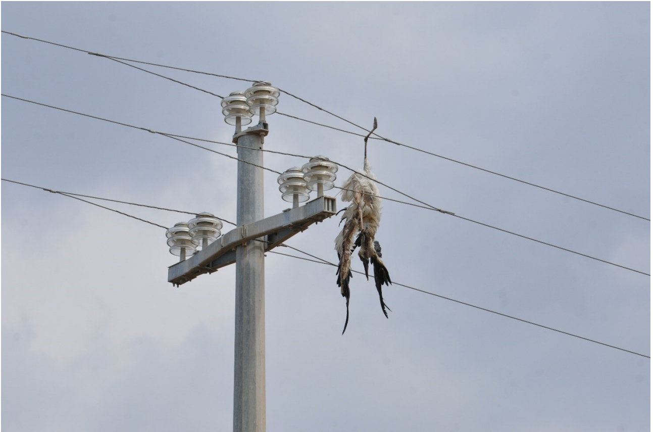
Fig. 18) Juv. morto per elettrocuzione sul sostegno T1-5 (Foto: Manuel Andrea Zafarana, discarica di Timpazzo - Gela, giugno 2018).
