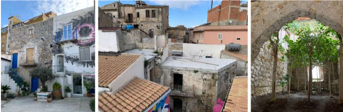
Fig. 4.4. A sinistra e al centro: rigenerazione dell'area dei sette cortili con pesanti interventi di ristrutturazione e brutali consolidamenti. A destra: ristrutturazione di Palazzo Miccichè con l'inserimento di un giardino al piano terra.
