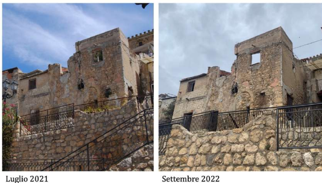
Fig. 3.44. Avanzamento dei crolli della parete di facciata di un'unità edilizia già in stato di rudere.
