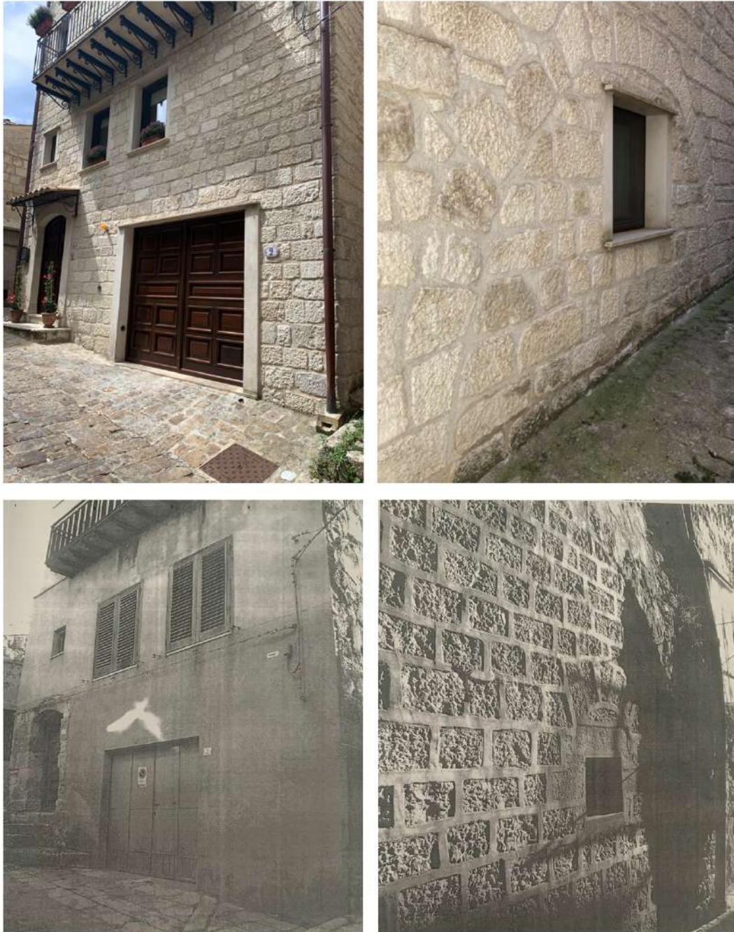
Fig. 4.12. Esempio di recente intervento di ripristino filologico in due edifici identificati come “casa a schiera ampliata”. Confronto tra la situazione attuale e quella precedente (fonte Archivio comunale). Il risultato è un intervento che, pur consentendo il riuso abitativo, privilegia un’immagine pittoresca del centro storico e non i suoi valori intrinseci.
