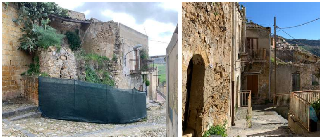
Fig. 3.40. Esempi di effetto contagio. A sinistra: crollo esteso della facciata con conseguente compromissione del cantonale inglobato. A destra: crolli estesi delle coperture in seguito a indebolimento del muro portante condiviso.
