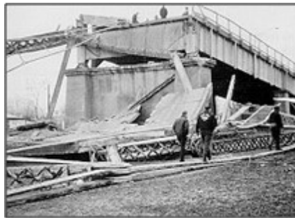
Figura 2 Point Pleasant Bridge dopo il crollo [6]
