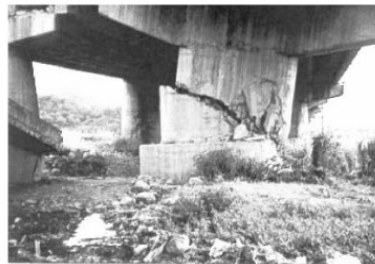
Figura 22 Collasso per taglio, Viadotto Wushi (terremoto di Chi Chi, Taiwan, 1999) [26]
