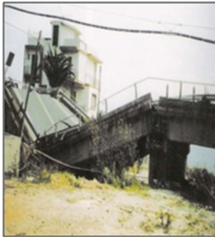
Figura 3 Crollo del Ponte S. Stefano [14]
