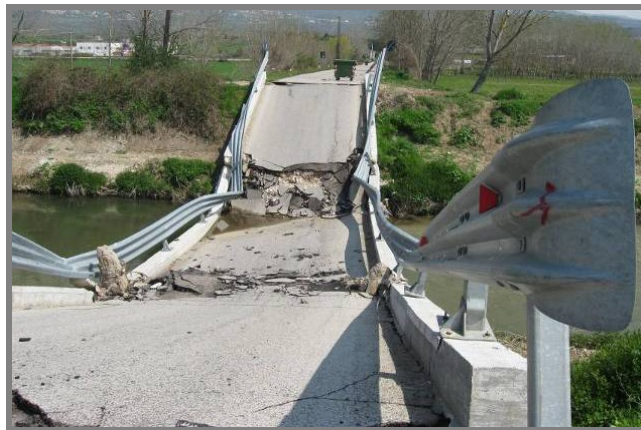
Figura 5 Crollo del ponte sul fiume Aterno [16]
